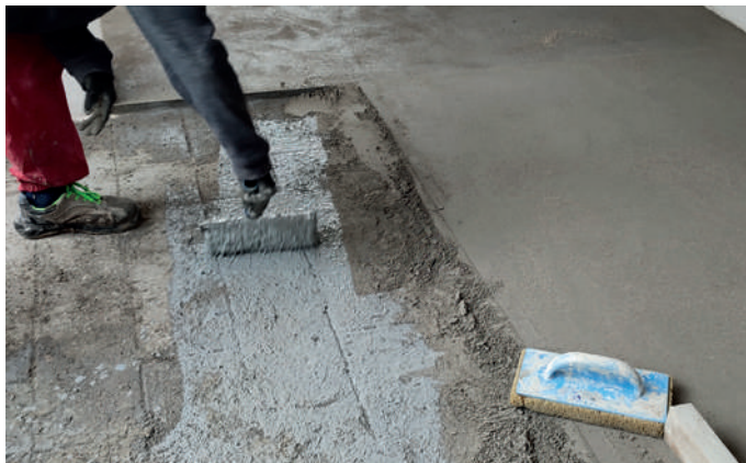
Posa della boiaccia di aggrappo con Lattice CentroStorico per la posa in aderenza del massetto delle pendenze QuotaZero.
