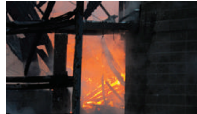
Parete in Lecablocco durante l'incendio. Le pareti in Lecablocco sono le uniche strutture rimaste intatte.
