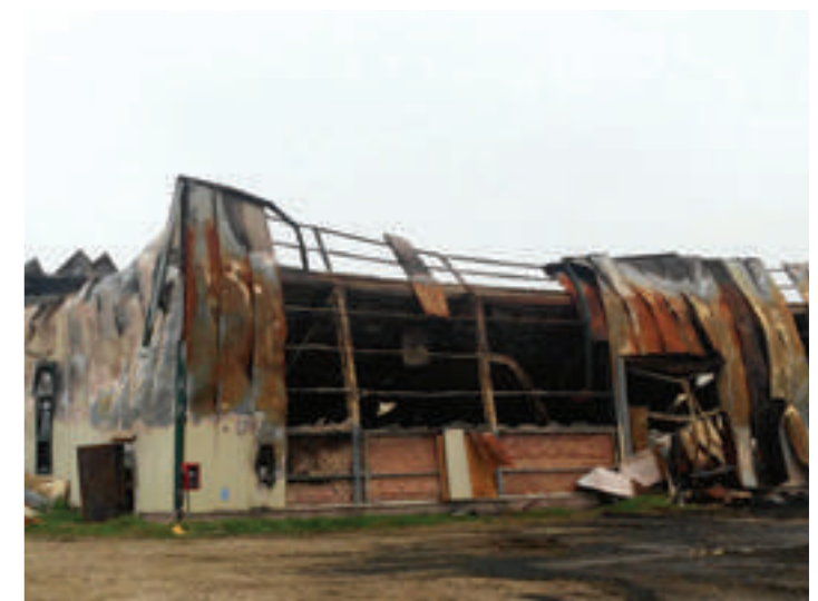
Stabilimento industriale con rivestimento metallico completamente distrutto in seguito ad un incendio.
