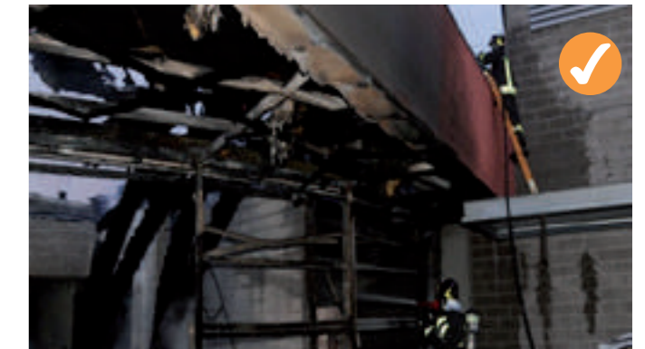
Fasi di spegnimento dell'incendio. Le pareti in Lecablocco Tagliafuoco perfettamente integre rendono più sicure le fasi di soccorso antincendio.
