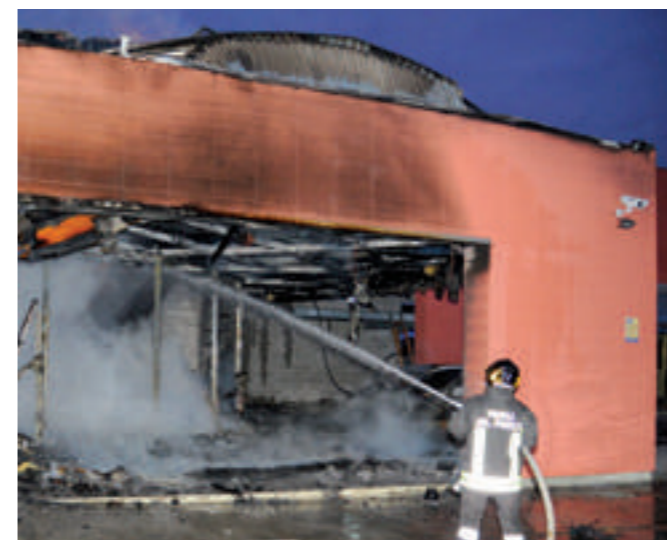
Edificio in Lecablocco dopo un incendio. Le pareti in Lecablocco sono rimaste perfettamente integre.
